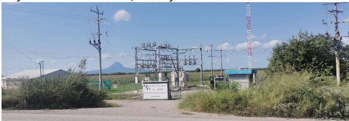
Imagen 15.- Subestación eléctrica, división golfo centro de González
