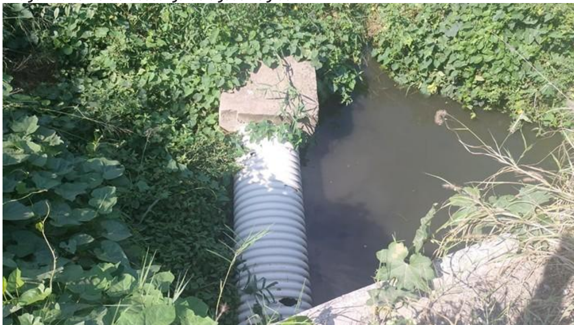
Imagen 4.- Sitio de descarga de aguas negras
